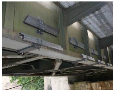
Absorbeur sur platelage
