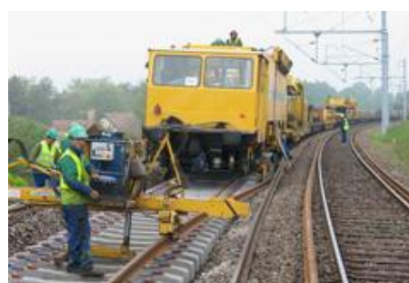
Longs Rails soudés sur traverses béton
